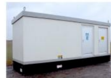
Exemple d'un poste de livraison (source : QUADRAN)
